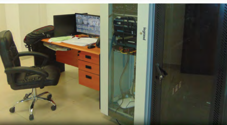
VUE PARTIELLE DE LA SALLE DE MACHINES PARTIAL VIEW OF THE MACHINES ROOM
